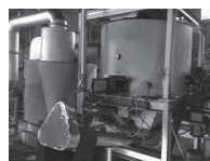
バイオマス ボイラー
